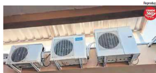
O Cidade 360 esteve no local e constatou problemas em aparelhos
