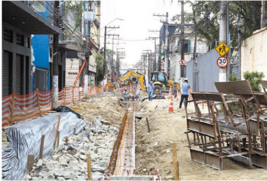
A Rua Constituição é um dos locais onde há obras da segunda fase do Veículo Leve sobre Trilhos
