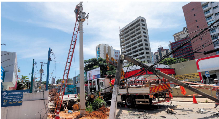
REPAROS Equipes da Enel passaram as últimas 24 horas consertando estragos, como os causados na Rua das Monções, em Santo André
