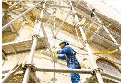
... fachada e cobertura têm recebido atenção especial. Reparos, agora, estão corretos, diz secretária...
