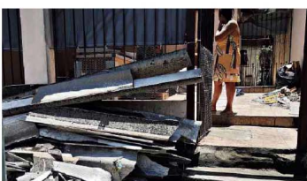
Telhos arrancados pelo temporal no Campo Limpo, na zona sul de SP
