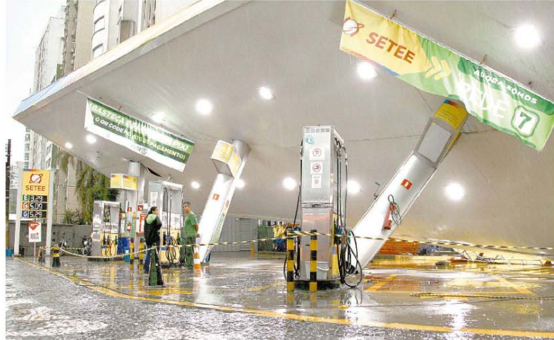
Cobertura deste posto de combustíveis na Aparecida não resistiu à força das rajadas de ontem à tarde. Pilar de sustentação da estrutura estava podre, de acordo com a Prefeitura
