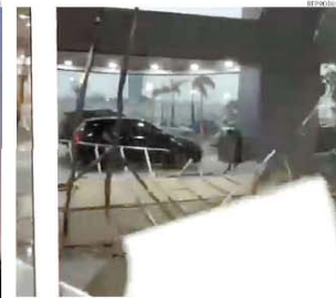
Placa de gesso desabou no Litoral Plaza Shopping, em Praia Grande
