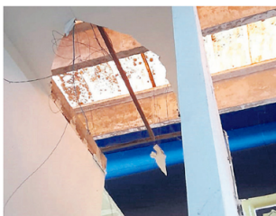
MANUTENÇÃO. Gesso do teto da sala de estoque caiu neste ano
