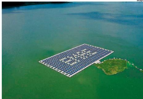
ENERGIA. Projeto-piloto foi instalado no reservatório em 2020; previsão é que iniciativa seja finalizada no fim deste ano
