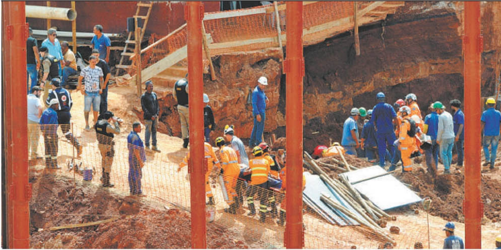
EQUIPES DOS BOMBEIROS ATUAM NO SOCORRO ÀS VÍTIMAS DO DESABAMENTO, QUE OCORREU QUANDO OPERÁRIOS E ENGENHEIRA TRABALHAVAM EM INTERVENÇÃO PARA SUSTENTAR O BARRANCO
