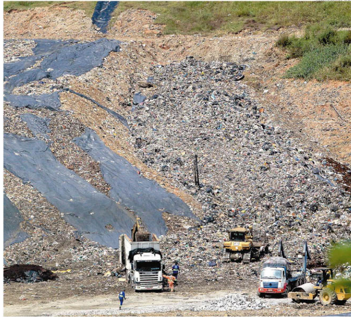
O aterro sanitário existente no Sítio das Neves, na Área Continental de Santos, é o único da região. Cerca de 40% dos resíduos são orgânicos.
