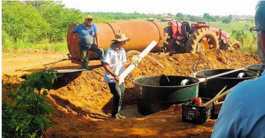
Instalação de sistema de fossa séptica em propriedade rural no bairro Guarú, no Distrito de Barão Geraldo, em Campinas; processo de decomposição aeróbica realizado por bactérias
