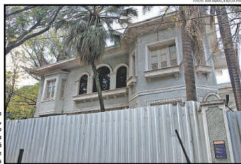
A Casa Azul, primeiro sede do Iepha, localizada no entorno da Praça da Liberdade, está fechada e cercada de tapumes.
