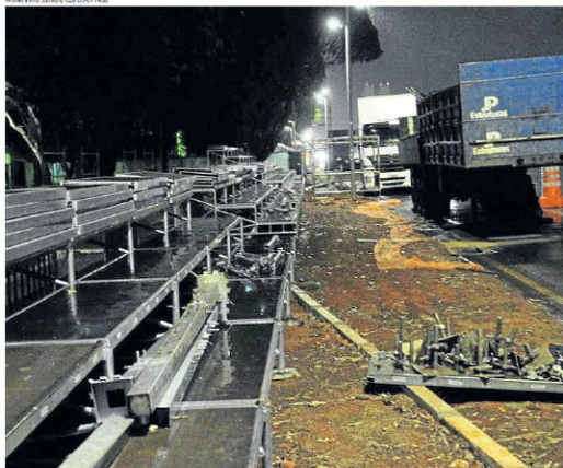
Os operários estavam montando uma das vigas de sustentação, quando ocorreu o acidente
