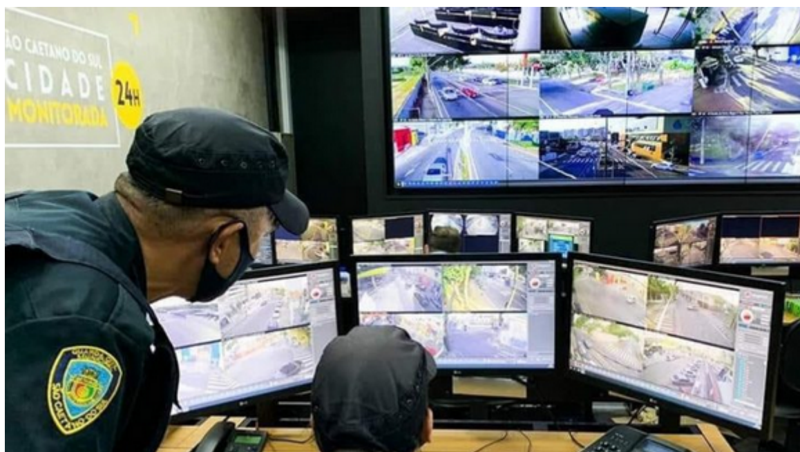
Centro de Gerenciamento de Emergências de São Caetano
