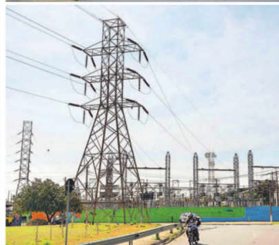
Torres de transmissão de energia elétrica em Campinas; CPFL informou por meio de comunicado oficial que a queda no serviço foi provocada por um desligamento do sistema nacional
