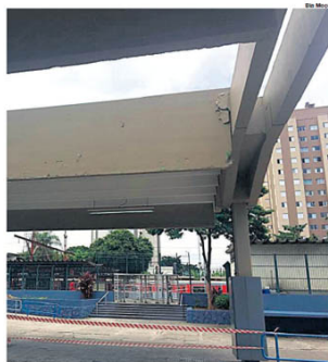
ISOLADA. Área foi interditada pela Defesa Civil e passará por obra
