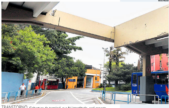
TRANSTORNO. Cobertura do terminal, que foi interditado, será reposta
