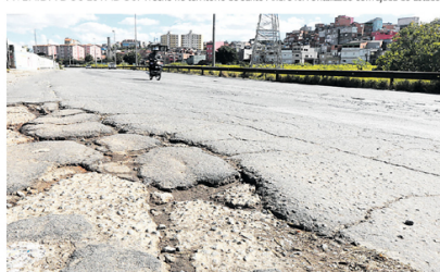
JÁ EM MAUÁ. Trecho da avenida de cerca de 1 quilômetro em Mauá está em péssimas condições
