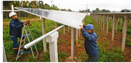
Mais painéis foram instalados em empreendimento da Nono Ludovico, em Eldorado do Sul
