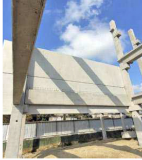
A superestrutura da nova UME Azevedo Júnior já pode ser vista por quem passa pelas imediações da Praça Nicolau Geraiçire
