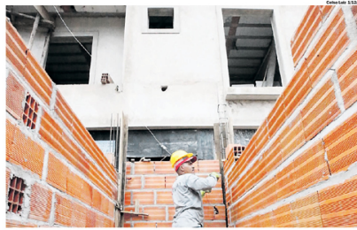
PRIORIDADE | Habitação, com R$ 32 bilhões, será o segmento com maior consumo em 2023
