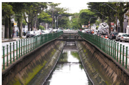
Segundo a Prefeitura de Santos, flutuante deve ser instalado em até 30 dias no Canal 5, para testes
