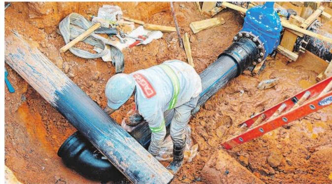
Até 2020, a Sanasa substituiu 450 quilômetros de redes antigas por tubulações em polietileno de alta densidade (PEAD); meta para o período de 2021 a 2024 é trocar mais 450 quilômetros
