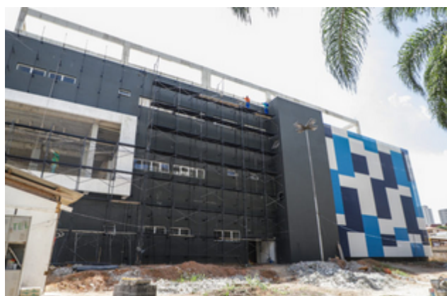
Construção do Centro de Excelência de Ginástica Artística e Rítmica de São Caetano entra em sua reta finalFoto: Prefeitura de São Caetano
