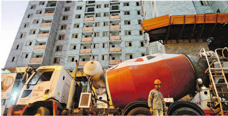
Novo empreendimento imobiliário que está sendo construído na Avenida Aquidabã, na região central de Campinas, integra a lista de 3.120 unidades habitacionais na cidade
