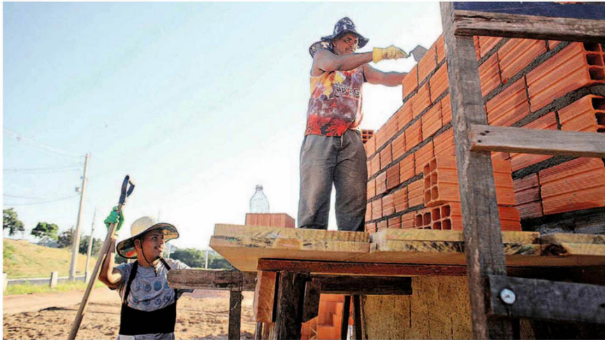
Na medida que as famílias assinam o contrato e começam o pagamento das parcelas, a equipe de construtores começa a levantar os muros do novo lar de 15 metros quadrados
