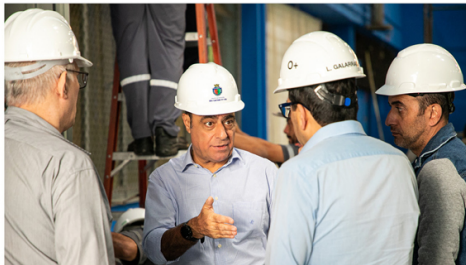
Auricchio realizou visita técnica às obras que já estão sendo realizadas no CER São José (Bochofólo)
