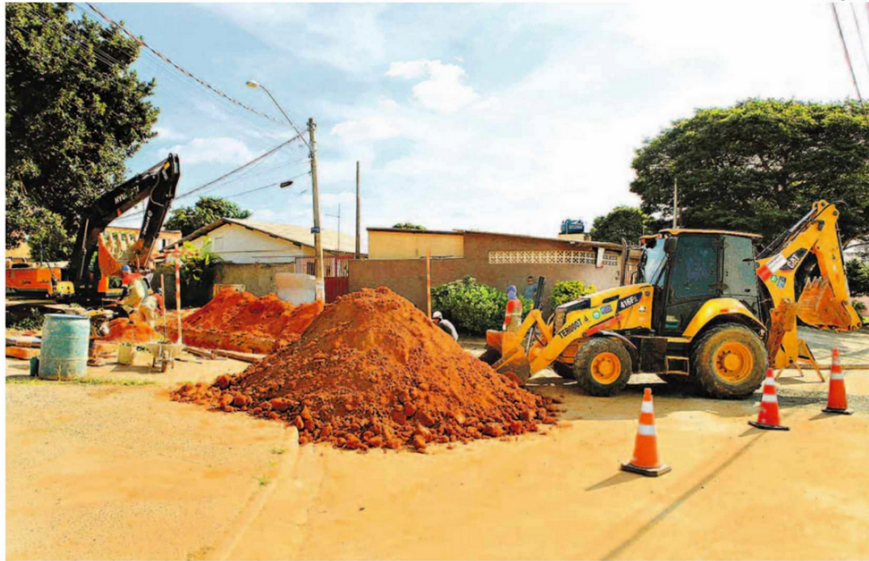
A movimentação de máquinas ganhou intensidade no Campo Belo com o início das obras de drenagem e asfaltamento das ruas, uma reivindicação de décadas dos moradores
