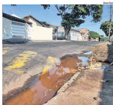
Vazamento grande na quadra 13 da rua São Vicente, na Vila Bela, região da Vila Pacifico, em Bauru
