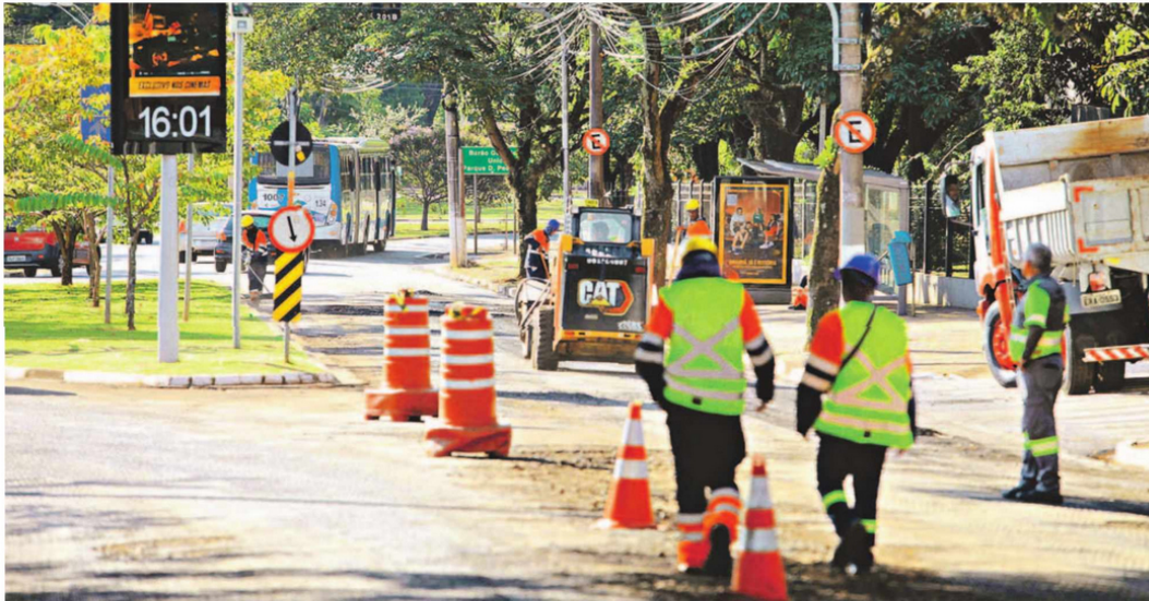
As obras de recapeamento de 70 quilômetros de vias de Campinas tiveram início ontem; as primeiras contempladas pelos trabalhos foram as avenidas Brasil e Barão de Itapura, ambas na região central da cidade
