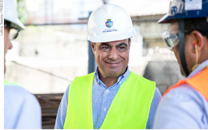
O prefeito José Auricchio Jr. visita obras no Viduá Independência, uma das contempladas no Avanço Auricchio obra e desenvolvimento de São Caetano
