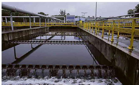
Decantador em estação de tratamento na Barra na Tijuca, no Rio
