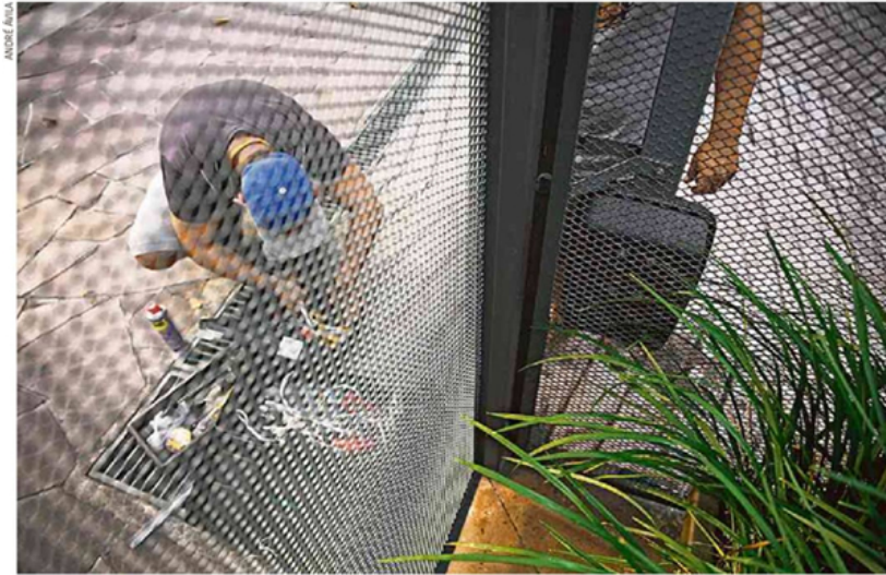
Portões arrombados na madrugada receberam reparos durante a tarde de ontem, em Porto Alegre
