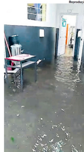
SEM AULA. Escola inundada
