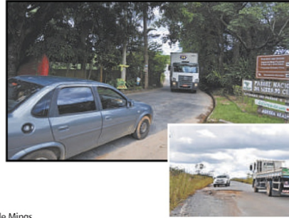
Na MG-010, ponte na direção da Serra do Cipó suporta a passagem de apenas um carro por vez. Em outro trecho da mesma estrada, buraco na pista é perigo para quem trafega
