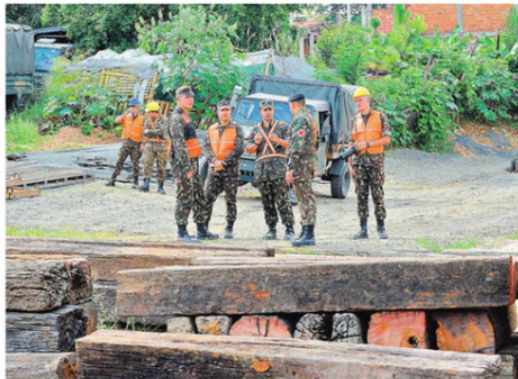
Militares do Exército trabalham na instalação de uma ponte de campanha no Jardim das Bandeiras
