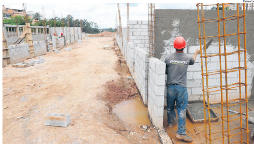
ANDAMENTO. Trabalhador atua na construção de unidade da Praça da Cidadania, em Mauá
