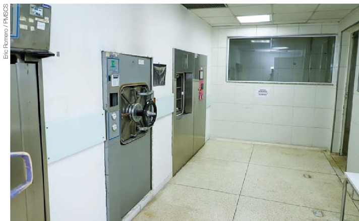
Serão adquiridas duas lavadoras termodesinfectoras, uma lavadora ultrassônica, duas autoclaves de alta temperatura, uma autoclave de baixa temperatura
