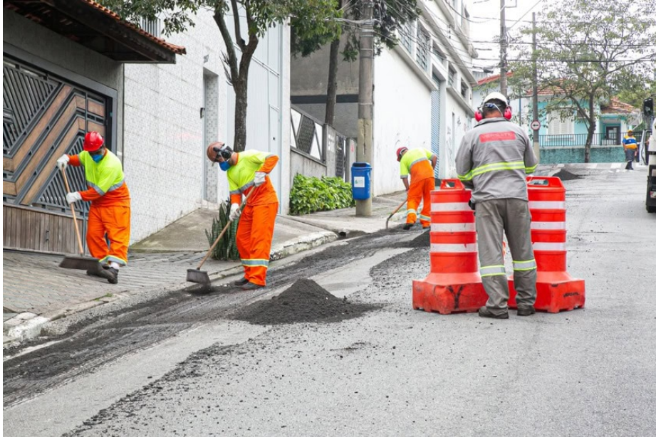
São Caetano inicia recapeamento da Rua Engenheiro Cajado de Lemos. Foto: Divulgação
