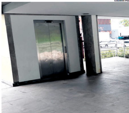
ACESSIBILIDADE. Equipamento não possui botão para ser acionado
