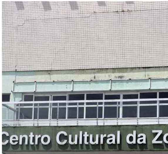
Em diversos pontos do piso superior, pode-se observar rachaduras. Uso está sendo evitado
