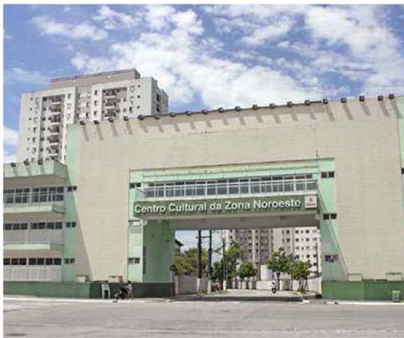
Andar superior e a passarela que divide os dois blocos do Centro Cultural estão comprometidos
