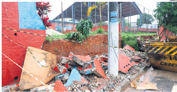
DESABAMENTO. Muro de escola estadual em São Bernardo caiu devido às fortes chuva do fim de semana
