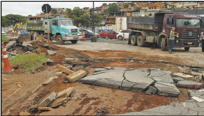
A força das águas provocou estragos no asfalto, mas obras em andamento minimizaram impactos em BH, afirma a administração municipal
