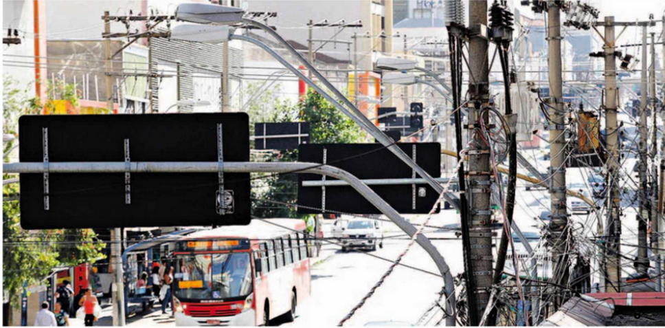
A poluição visual e os transtornos causados pelo emaranhado de fios da rede elétrica e cabos de telefonia darão lugar a um cenário limpo de rede aterrada na Avenida Campos Sales
